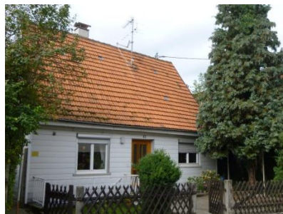
Baulicher Missstände und Fassadenmangel; Quelle: die STEG
