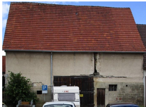
Substanzielle Mängel, Obere Straße 12 Quelle: die STEG
