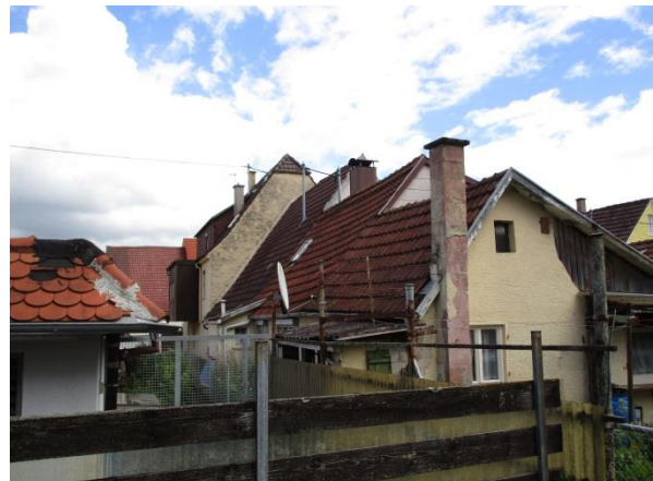
Substanzielle Mängel, Hauptstraße 28 und 30 Quelle: die STEG
