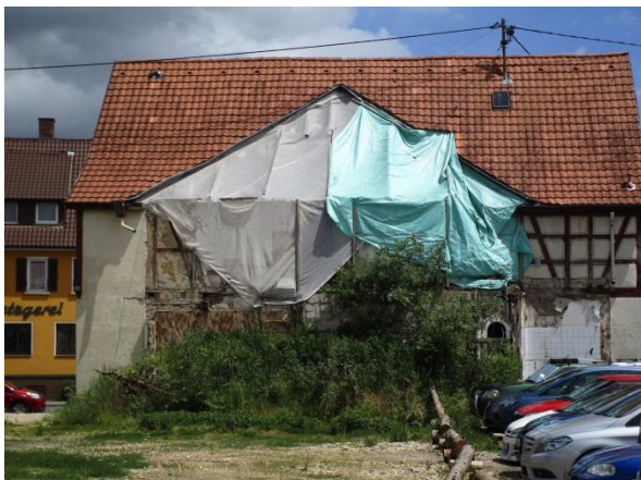
Substanzielle Mängel, Hauptstraße 41 Quelle: die STEG
