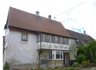
Bauliche Missstände Quelle: die STEG
