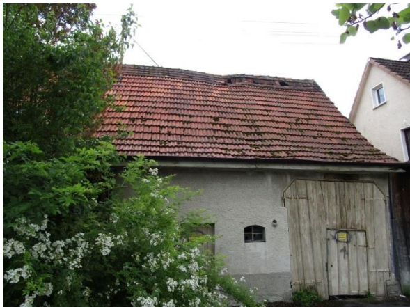
Substanzielle Mängel, Gartenstraße 21 Quelle: die STEG
